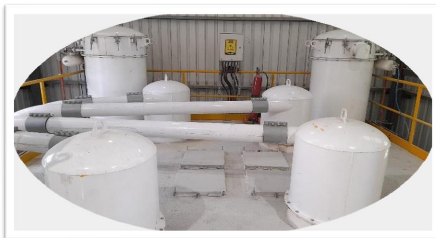
Imagen No 25. Filtros manga de la extruder Ferraz 10
