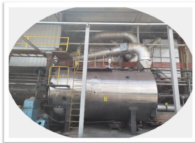
Imagen No 24 Ciclones y Multiciclón de la caldera
