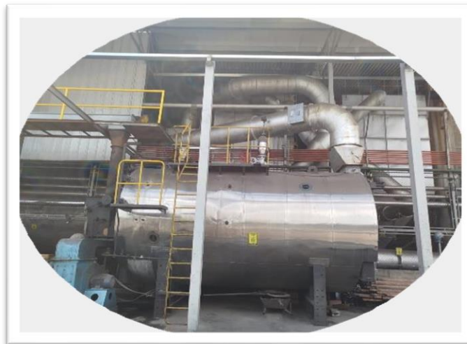
Imagen No 24 Ciclones y Multiciclón de la caldera
