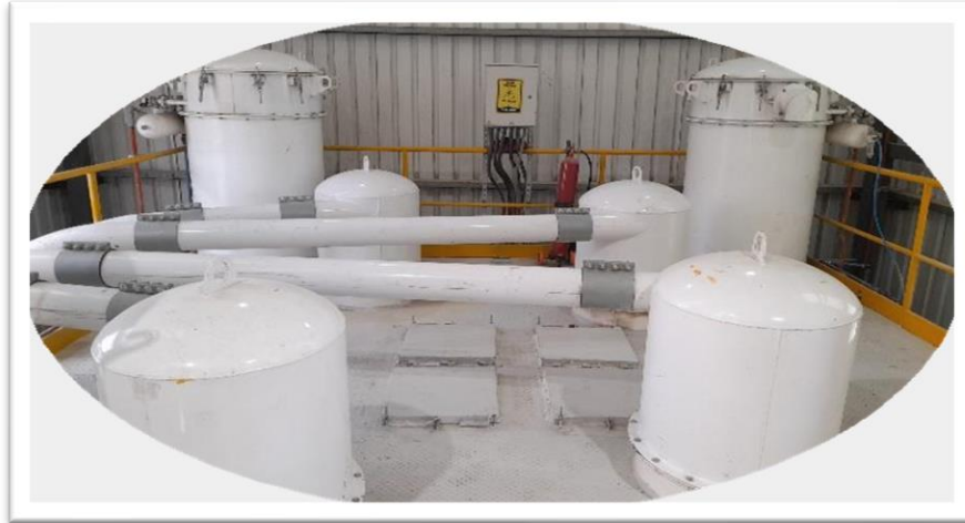
Imagen No 25. Filtros manga de la extruder Ferraz 10
